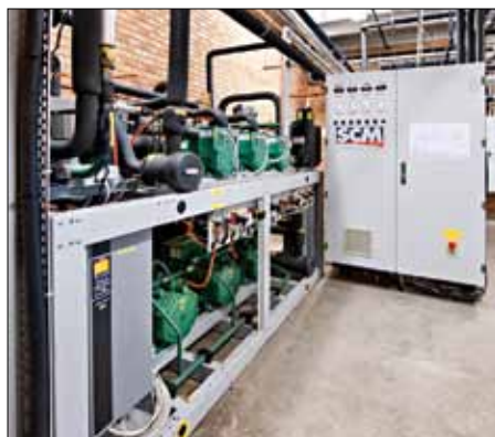
Den transkritiska anläggningen tillverkad av SCM Frigo har en total effekt på 222 kW (kyl) resp. 42 kW (frys).
